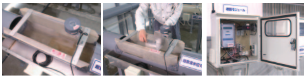
フリューム・水位検出器
