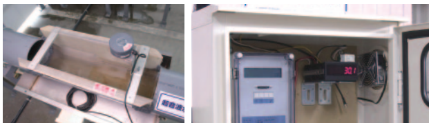
フリューム水位計測、試験流量指示
